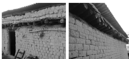
图 9 哈尼土掌房典型震害
