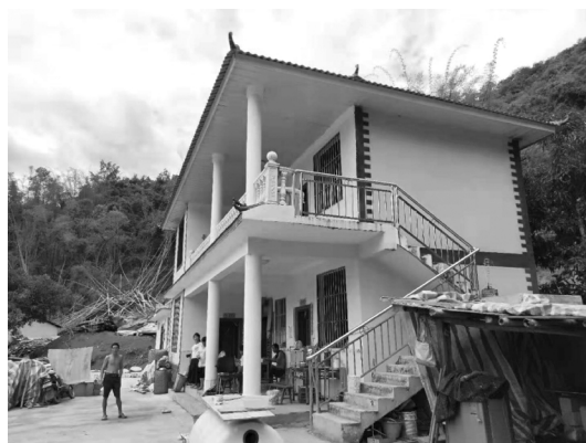
图 10 砖混结构房屋典型震害
