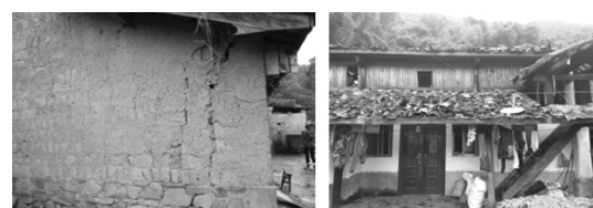
(d)墙体开裂、梭掉瓦
