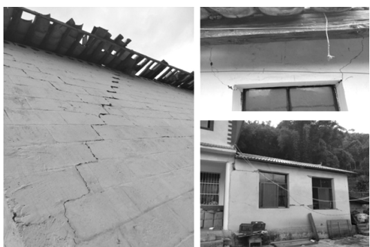
图 8 砖木结构农房典型震害
